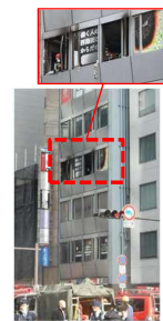
【火災建築物 外観】
